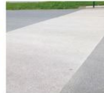
Résine gravillonnée pour les traversées cyclables sur chaussée
